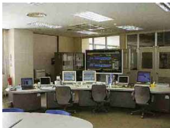
浄水場中央管理室
